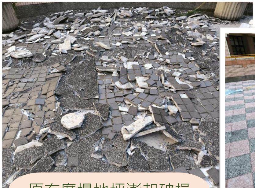
原有廣場地坪澎起破損
